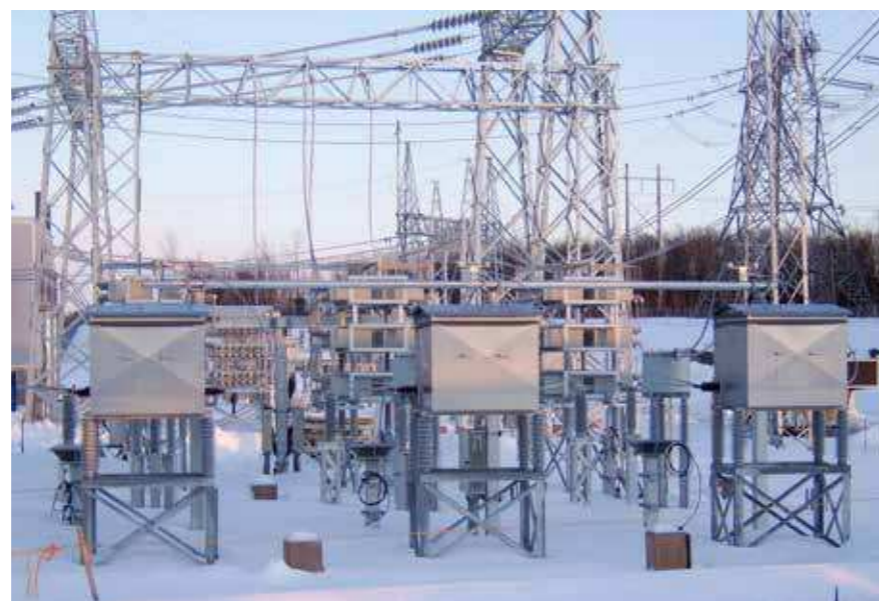
Resistenze filtro d'armonica HVDC&SVC
