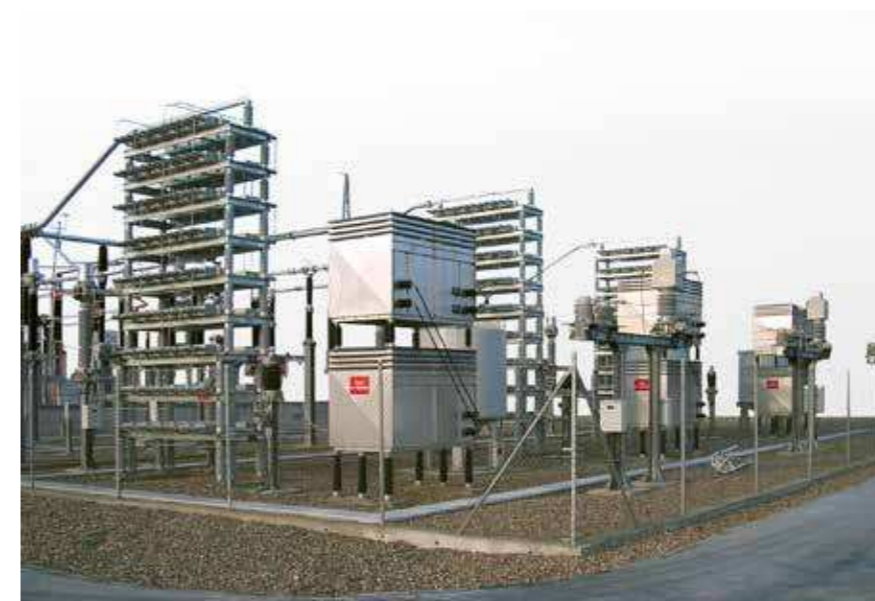
Resistenze filtro d'armonica HVDC&SVC
